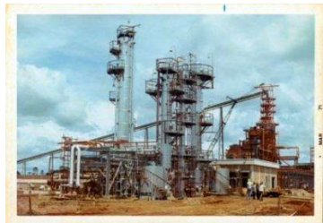
Figura 3 – Torres de Lavagem, Torre de Absorção e Torre Regeneradora da Unidade de Tratamento de Gás Ácido - UTGA
