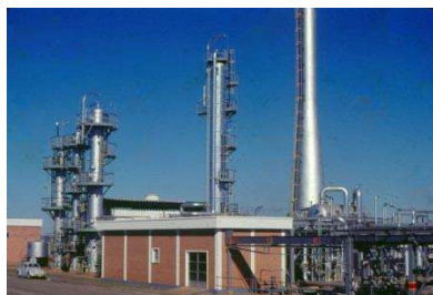
Figura 2 – Mostra as Torres de Lavagem Química, de Absorção Química com Solução de Amina, de Regeneração da Solução de Amina da UTGA, o Incinerador de Gás Residual da URE e Casa de Controle da Área 7
