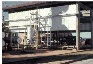
Figura 3 – Mostra a Casa de Compressores da Unidade de Tratamento de Gás Ácido - UTGA
