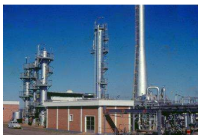
Figura 2 – Mostra as Torres de Lavagem Química, de Absorção Química com Solução de Amina, de Regeneração da Solução de Amina da UTGA, o Incinerador de Gás Residual da URE e Casa de Controle da Área 7
