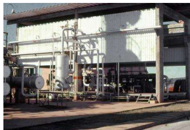
Figura 3 – Mostra a Casa de Compressores da Unidade de Tratamento de Gás Ácido - UTGA
