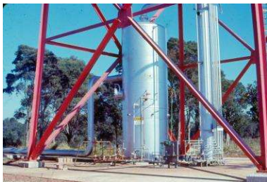
Figura 2 – Vista do Vaso Separador Gás-Líquido e Acessórios
