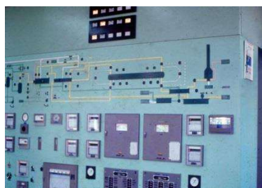
Figura 11 – Vista parcial do Painel Gráfico mostrando o Fluxo de Processo e Instrumentação da Unidade de Recuperação de Enxofre
