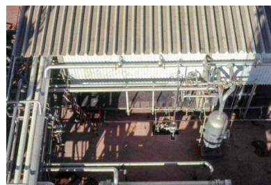
Figura 4 – Vista de Cima da Casa de Compressores da Unidade de Tratamento de Gás Ácido - UTGA
