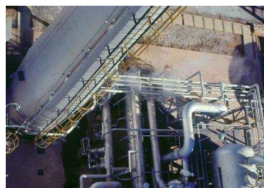
Figura 6 – Vista de Cima mostrando parte do Incinerador de Gás Residual, os Condensadores de Enxofre, os Aquecedores de Linha e parte dos Reatores da Unidade de Recuperação de Enxôfre - URE
