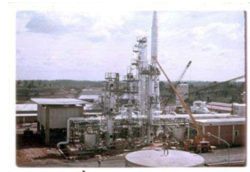
Figura 9 – Vista da Unidade de Tratamento de Gás Ácido - UTGA
