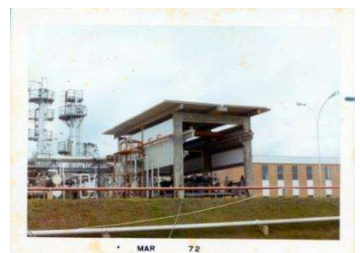
Figura 4 – Casa dos Compressores da Unidade de Tratamento de Gás Ácido - UTGA
