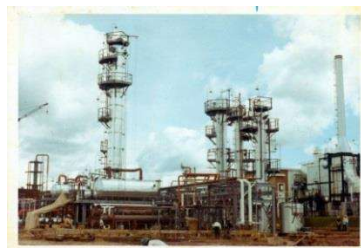
Figura 6 – Vista Geral da Unidade de Tratamento de Gás Ácido - UTGA
