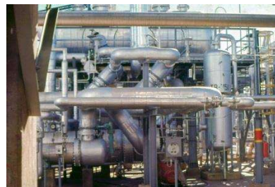
Figura 5 - Mostra o Tambor de Gás Ácido, os Condesadores de Enxofre, os Aquecedores de Linha e os Reatores da Unidade de Recuperação de Enxofre - URE
