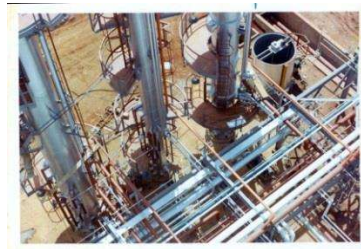
Figura 7 – Vista da Bancada de Tubulações da Unidade de Tratamento de Gás Ácido - UTGA
