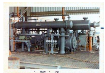
Figura 5 – Compressores de Gás Ácido da Unidade de Tratamento de Gás Ácido - UTGA
