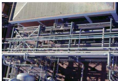
Figura 9 – Vista de Cima mostrando parte da Bancada de Tubulações, junto à Casa de Controle da Área 7
