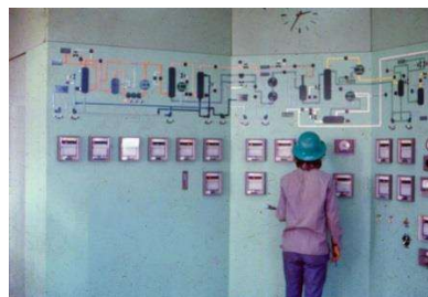
Figura 10 – Vista parcial do Painel Gráfico mostrando o Fluxo de Processo e Instrumentação da Unidade de Tratamento de Gás Ácido - UTGA
